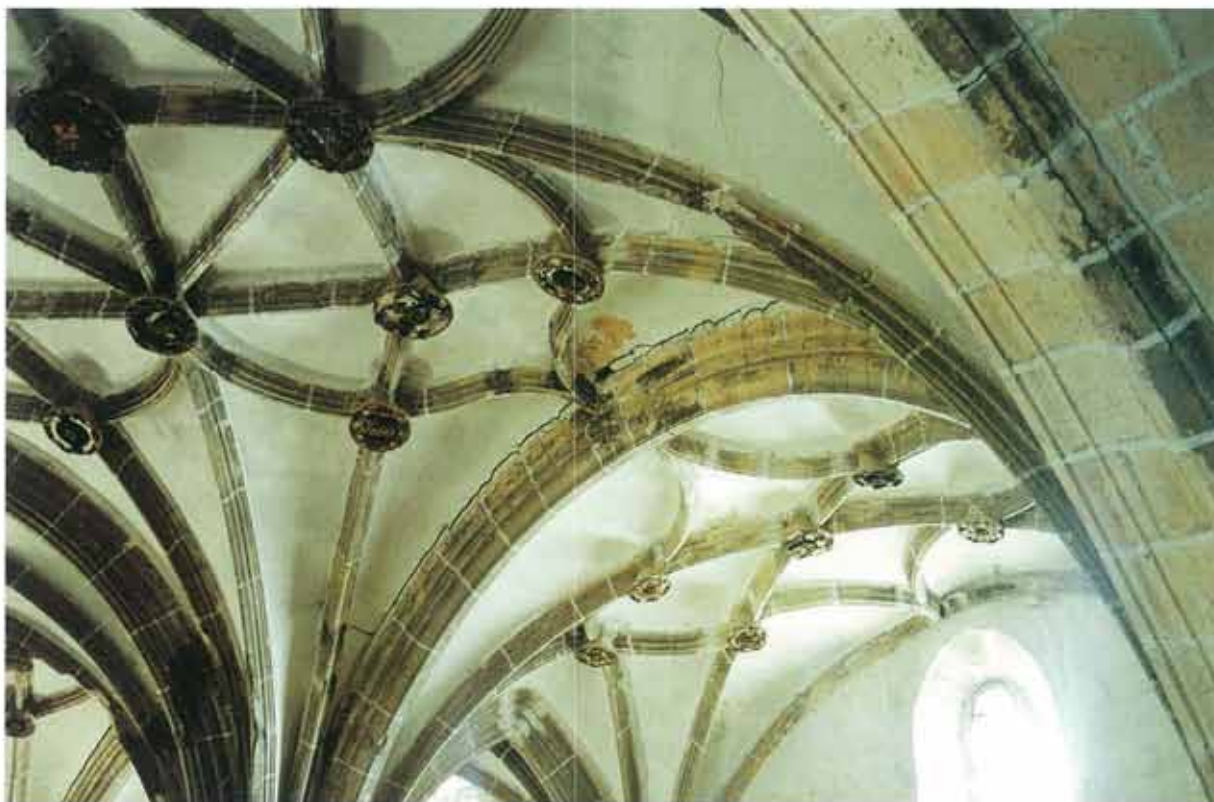
Detalle de la fisuración en las bóvedas, por separación entre el arco y la plementería
