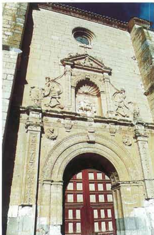
Detalle de la portada principal, apreciándose la alteración del material pétreo de las hiladas inferiores, posiblemente por acción hídrica capilar.
