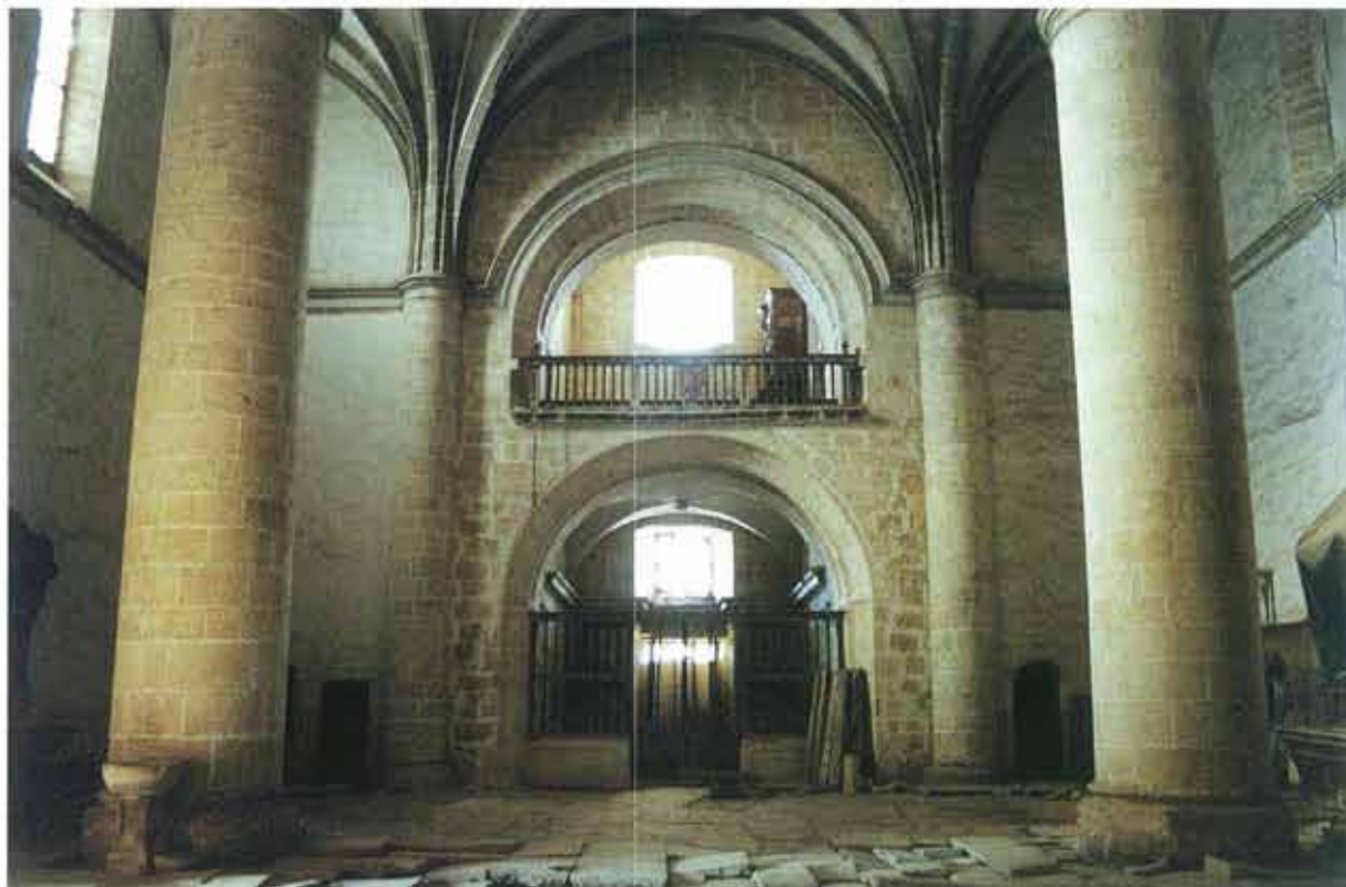
Vista parcial del muro Oeste de la iglesia y detalle del coro
