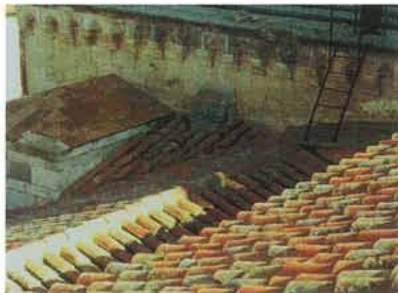
Estado de los faldones de teja, con piezas rotas o removidas; las limas presentan obstrucciones
