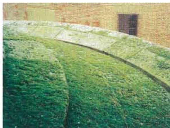
Cubierta del ábside lateral norte; existencia de líquenes e indicios de altos contenidos de humedad capilar
