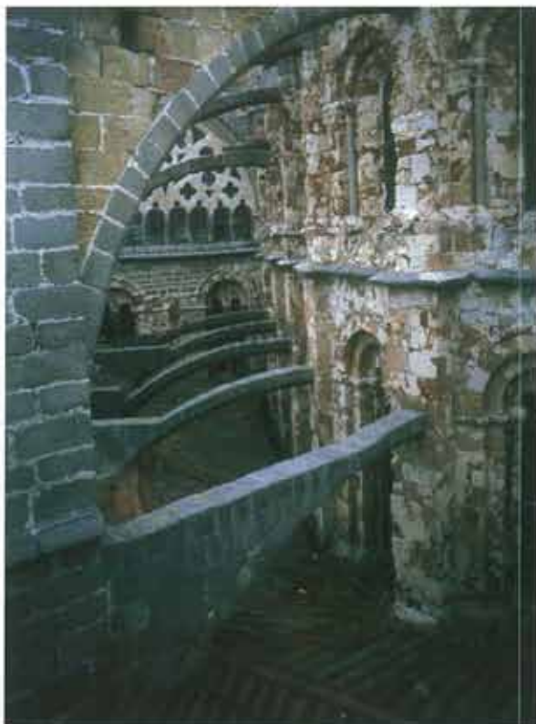
Adarve bajo. Estado inicial
