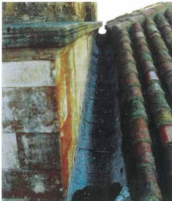
Limahoya entre faldones de teja. Estado inicial
