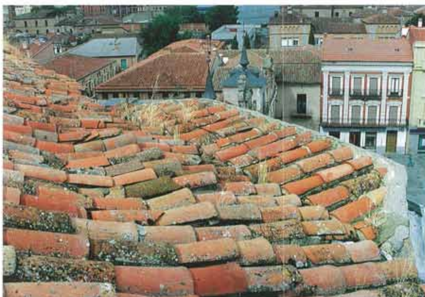
Estado inicial cubierta
