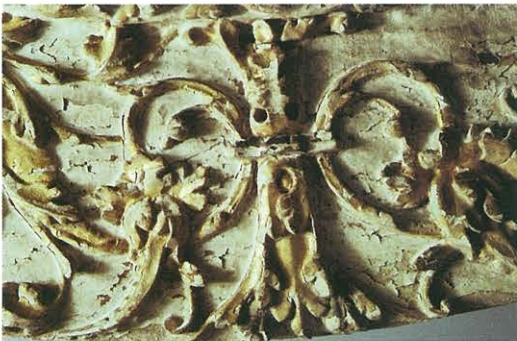
Detalle de levantamientos y lagunas en la capa pictórica (pieza de la arquitectura).
