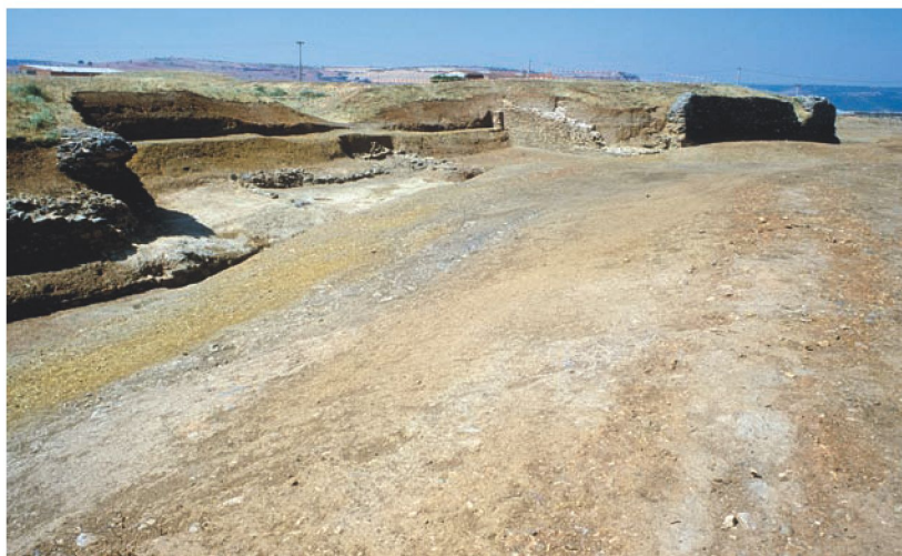
Vista general una vez hecha la excavación, donde se aprecia la pérdida de fábricas en cortinas y baluarte
