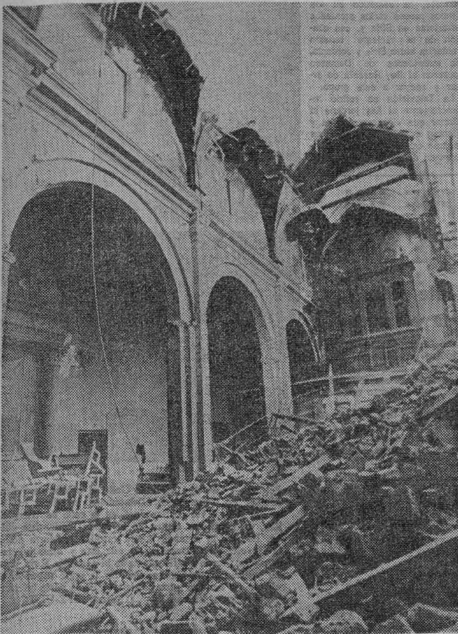
Córdoba. — Ocurrió la pasada Nochebuena, a mediodía se derrumbó la techumbre de la iglesia de Santiago Apóstol, de Córdoba, en ella se encontraban trabajando 12 albañiles que este día no asistieron al trabajo por ser Nochebuena. Ello pudo salvar sus vidas. Esta iglesia sufrió un aparatoso incendio el 20 de Diciembre del pasado año. Los daños tras el derrumbamiento de este año son cuantiosos. — (Telefoto Europa Press)
