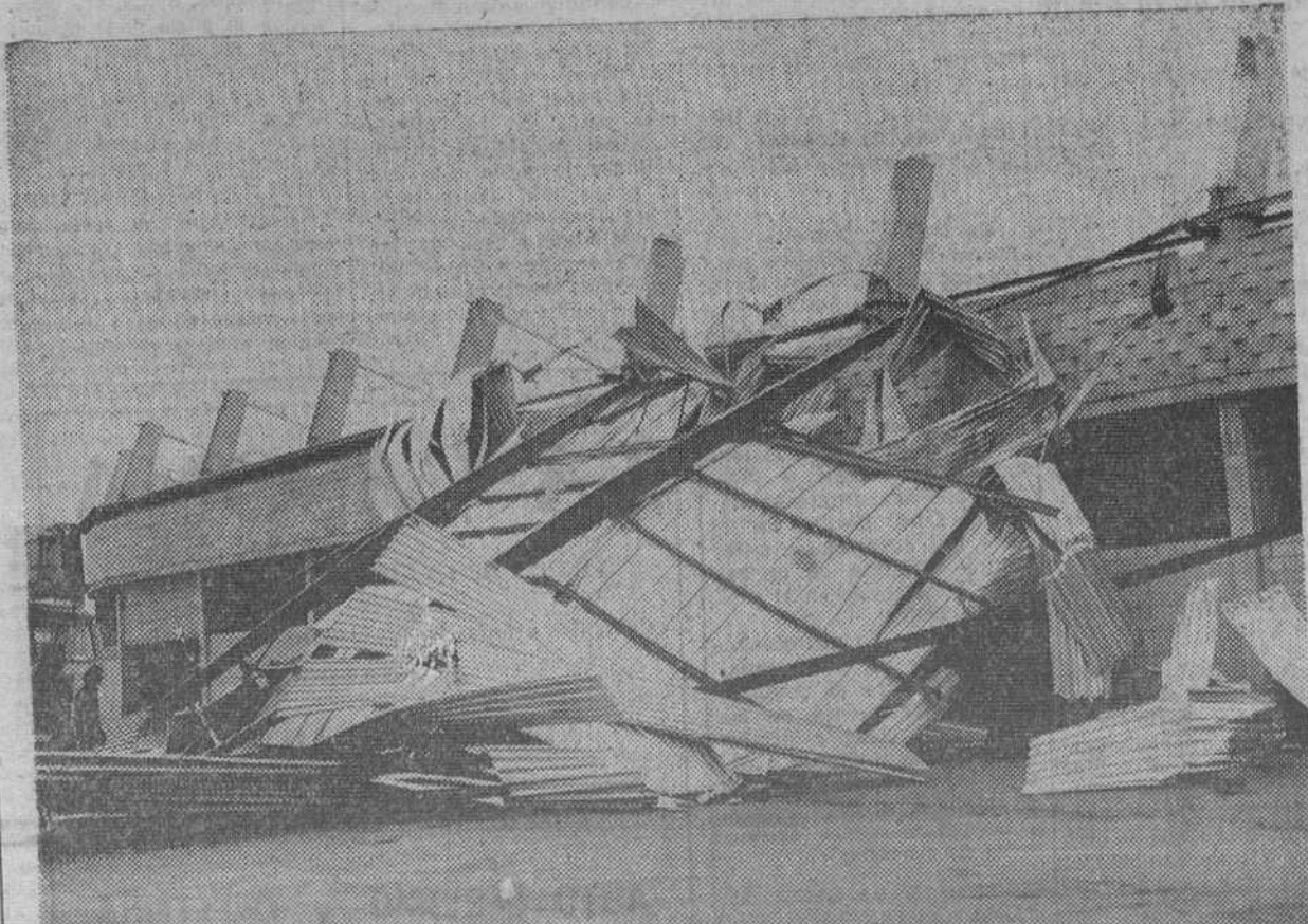
Salamanca. — Unos 700 metros cuadrados de cubierta del estadio Helmántico, se hundieron a causa del fuerte vendaval que azotó la provincia de Salamanca. Por fortuna el estadio estaba vacío y no hubo que lamentar víctimas. — (Foto CIFRA GRAFICA).
