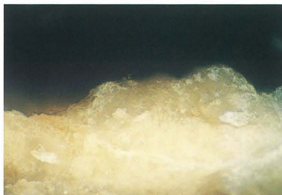
Estratigrafía de la patina de la cornisa del Colegio de Santa Cruz. Limpieza con láser. Condiciones de trabajo: haz convergente, fluencia de 4,6 J/cm 2 . Limpieza agresiva con pérdida de pátina
