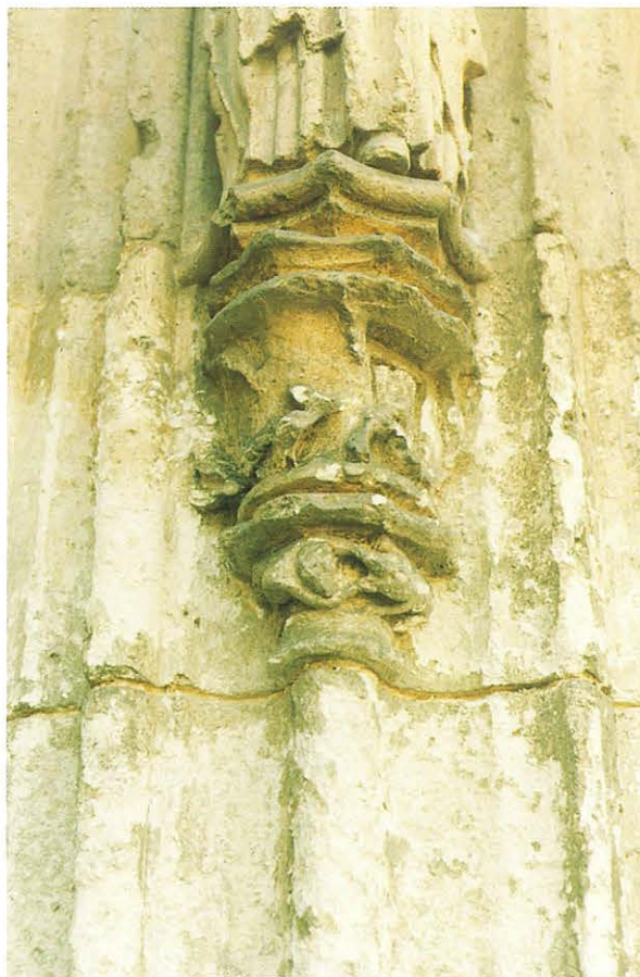
Inicio de los daños por cristalización en elementos escultóricos de la zona inferior
