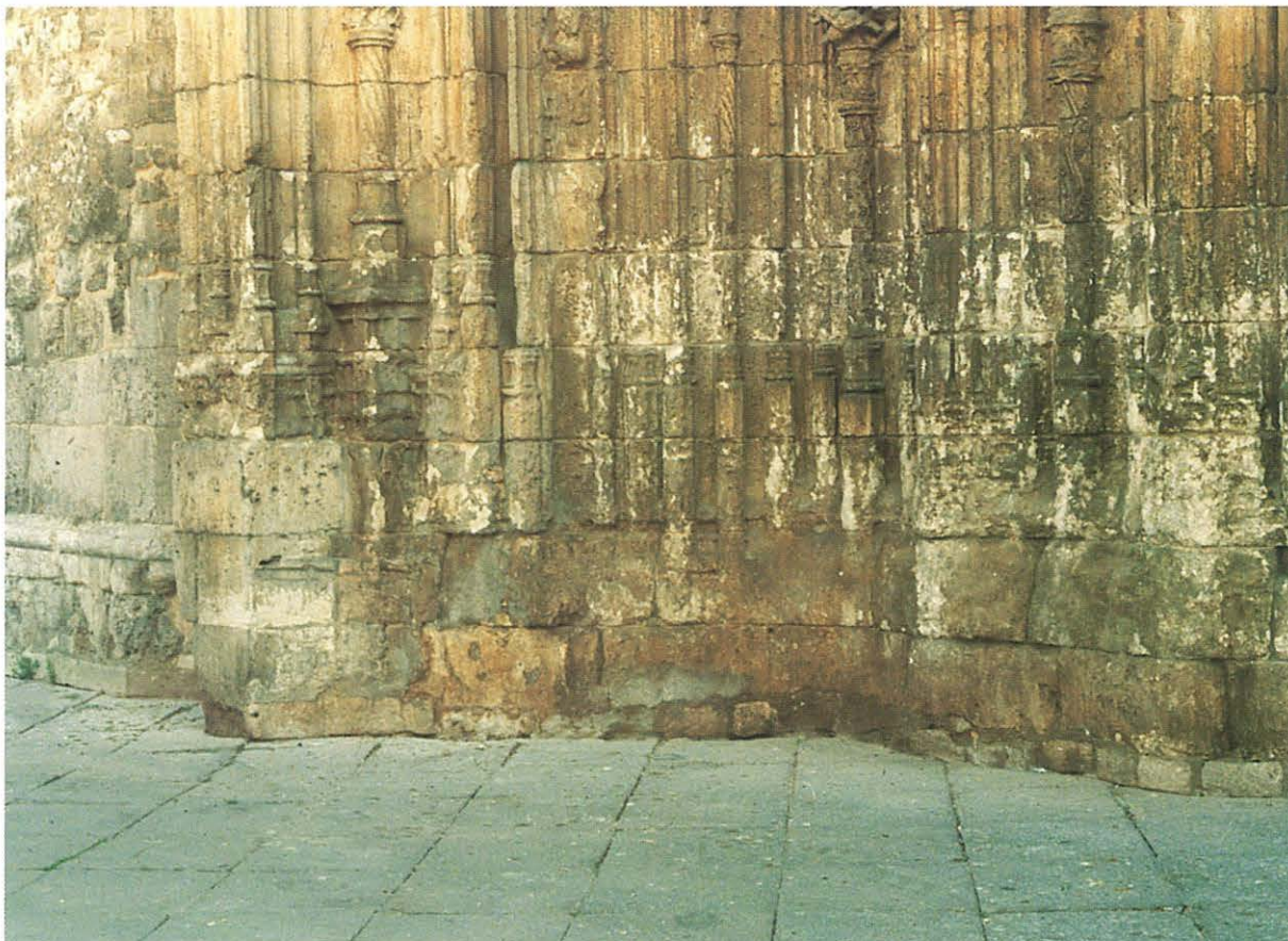
Vista general de los efectos de la humedad de ascensión capilar y la cristalización de sales solubles
