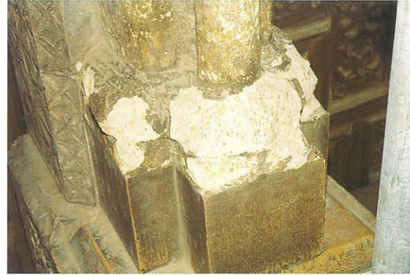
Daños mecánicos producidos por la acción antrópica en el pilar de la Virgen del parteluz
