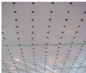
Entrada de aire por el techo.
