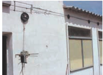
Sistema de apertura automática de las persianas.
