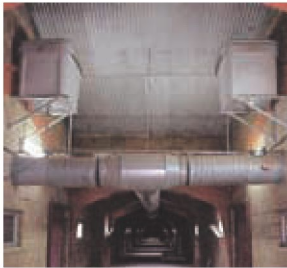
Generadores de aire: se trata de una calefacción ambiental. Producen aire caliente.
