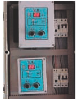
Cuadro de control automático de condiciones ambientales de la sala.
