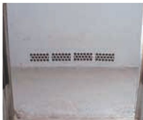
Entrada de aire en la nave.
