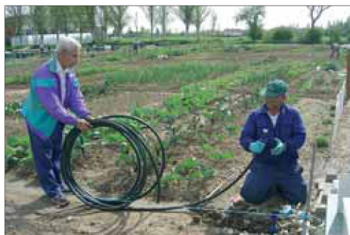
14.2: instalación de la tubería general de polietileno de una pulgada (25,4 mm) que va conectada a la toma de agua
