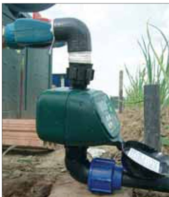
14.1: instalación de un programador a la entrada de la parcela; este programador nos va a permitir regar en los momentos que deseemos sin necesidad de estar presentes en el huerto
