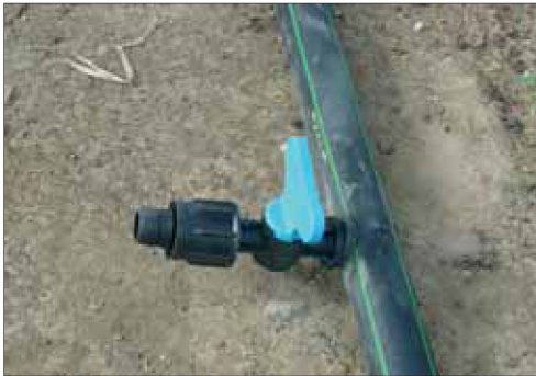
14.5: llave de paso insertada en la tubería general
