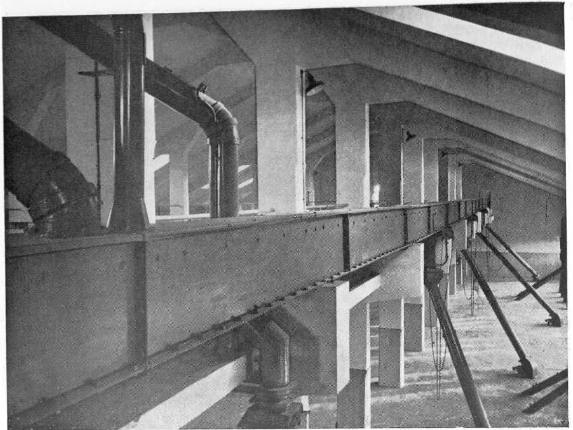
Foto núm. 46.—Silos de tránsito. Transportadores distribuidores.
