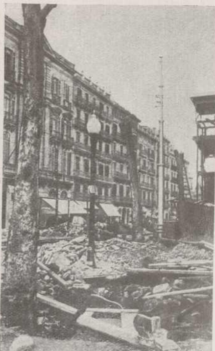
La Ronda de St. Pere remuguda per les obres de prolongació del Metro.
