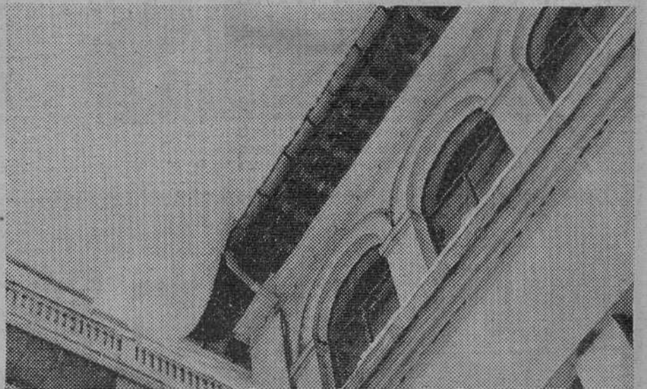
Los aleros de los tejados de todas las edificaciones burgalesas presentaban aspectos peligrosos por la acumulación de nieve, como apreciamos en esta foto captada por «Fede» en el grupo escolar «Generalísimo Franco»
