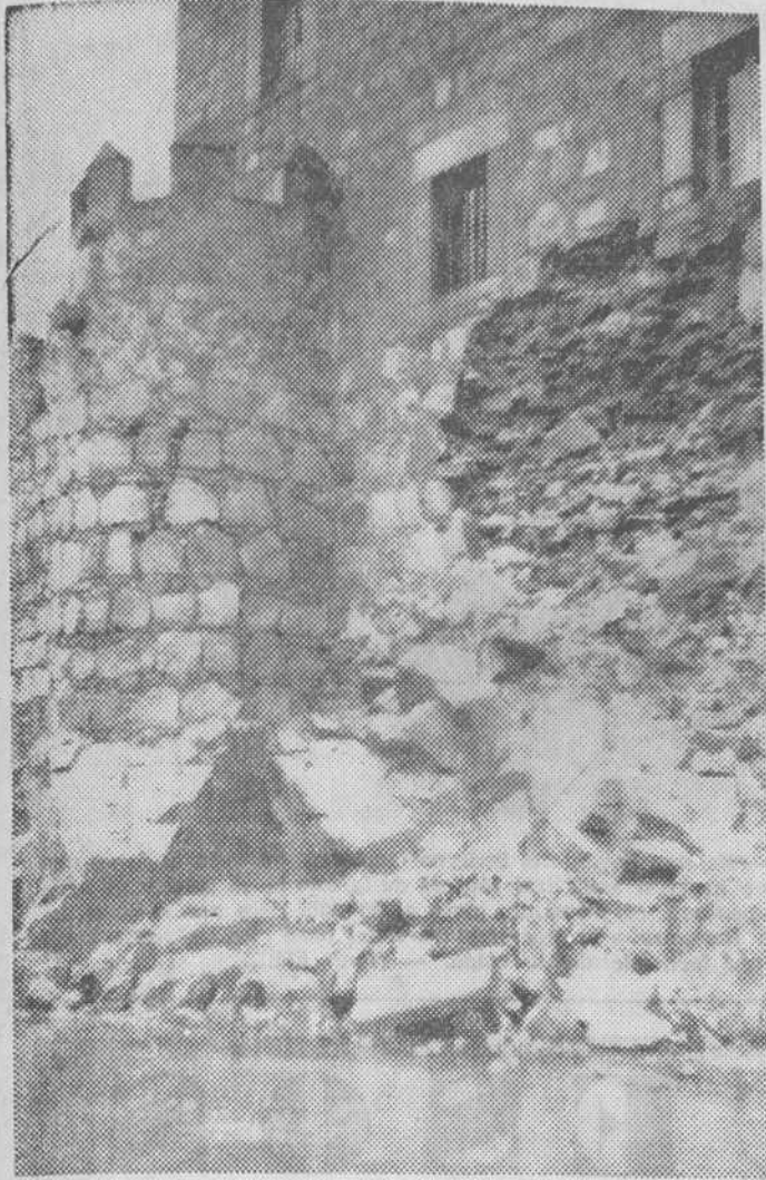
Como consecuencia de las lluvias torrenciales caídas durante los últimos días sobre Avila, se ha derrumbado parte de la célebre muralla de la ciudad. En su lienzo Sur se han desprendido grandes bloques de granito en una extensión de unos doce metros cuadrados. Si las lluvias continúan se temen nuevos derrumbamientos en el más característico de los monumentos abulenses. — (Foto FIEL)
