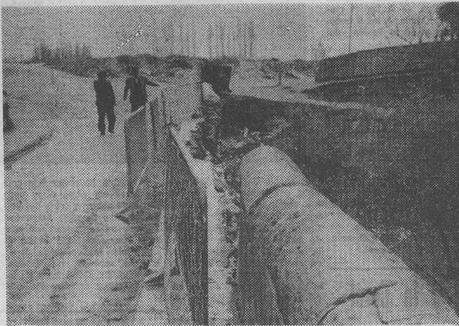
Vista del pretil del puente Conchuela, hundido a consecuencia de las intensas lluvias de la noche del 9 al 10 en Aranda de Duero. — (Foto REYES)
