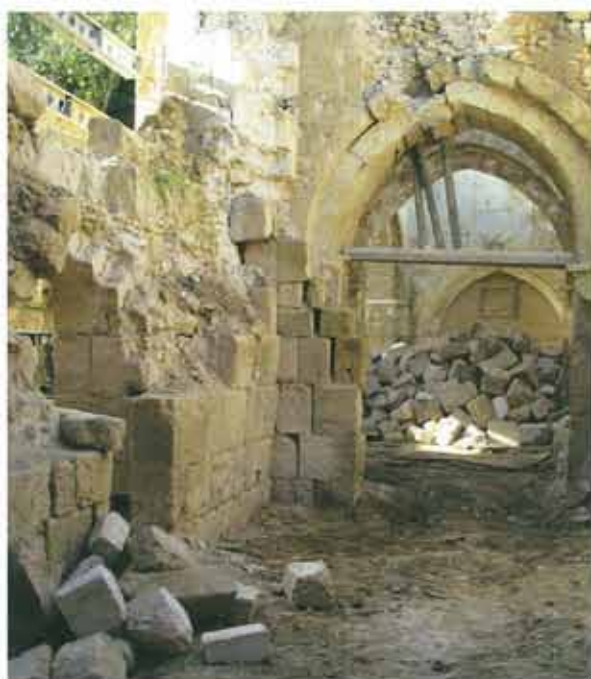
Vista general de la nave lateral hacia el abside durante la fase de desescombro
