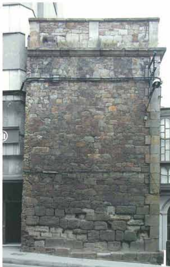
Detalle de una de las grietas en el cubo de la muralla
