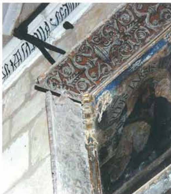
Estado previo de la parte superior del retablo, guardapolvo izquierdo
