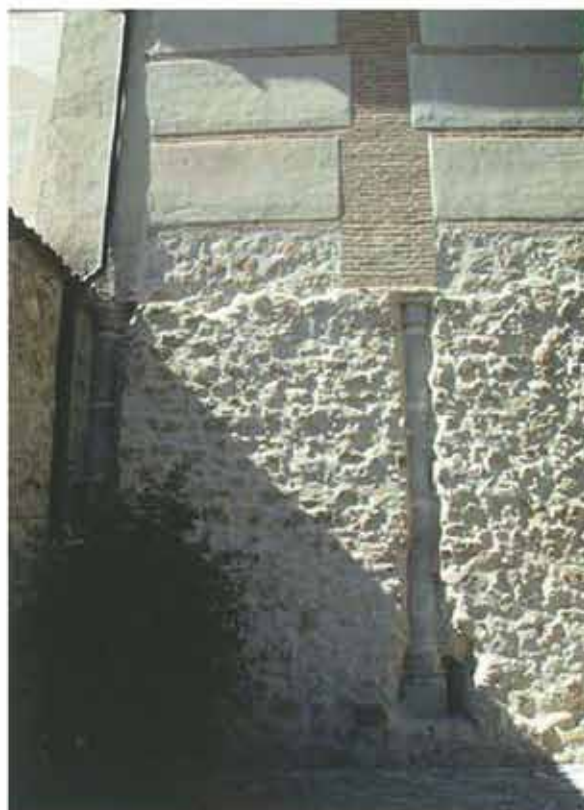
En las dos imágenes, se aprecian las columnas mudéjares embutidas en el muro ciego
