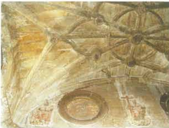
Aspecto de las pinturas policromadas en su estado inicial
