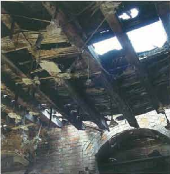
Detalles de la carbonización de toda la vigería y entablado, con el consiguiente colapso de la armadura y tejado sobre la alfarja de la planta bajo cubierta.
