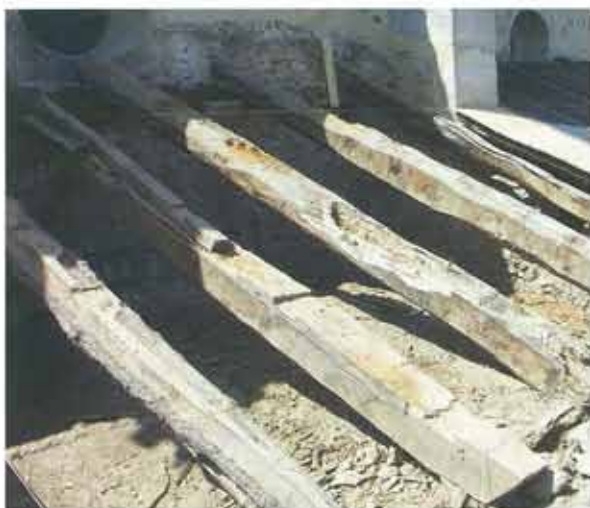
Detalles del deterioro de la tabla y estructura de la cubierta
