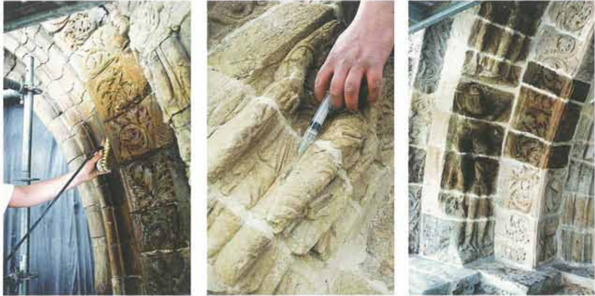
En la izquierda eliminación de restos mediante pulverización y cepillado simultáneo. En el centro, inyección de resina fluida para la eliminación de filtraciones de agua, frenar el deterioro y evitar el progresivo desprendimiento de las zonas fragmentadas. A la derecha, aplicación de consolidante, en zonas arenizadas, mediante impregnación con brocha, para favorecer la penetración del producto.
