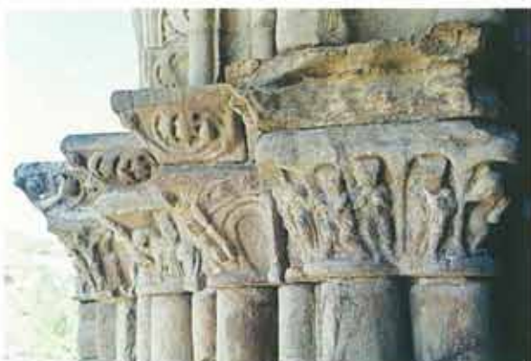
Estado inicial. Detalle de los capiteles del lado izquierdo de la portada, en la que se observa restos de pátina artificial, de entonación rojiza, cuyo microanálisis ha puesto de manifiesto que se trata de una capa de yeso pigmentada con óxidos de hierro. También se han analizado unas muestras de patina de origen natural, cuyo elemento cromógeno es el hierro, y su intensidad viene condicionada por la proporción del mismo.
