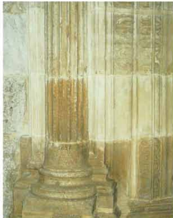
Estado final de la jamba
