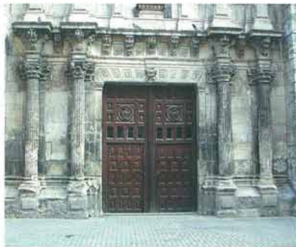
Detalles del deterioro de la fachada
