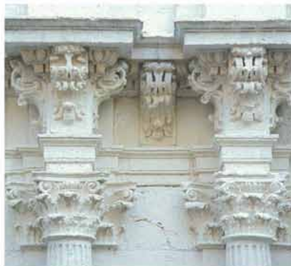
Estado comparativo de los capiteles en su estado previo y estado final
