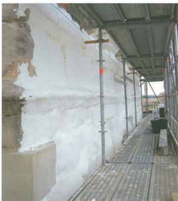
Tratamiento de desalación
