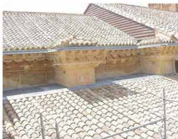
Detalle del friso pictórico tras la intervención, con la estructura de protección de las pinturas.
