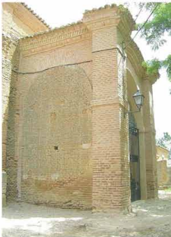
Aspecto previo de la portada abierta en el lado de la epístola y detalle de la misma en la que se observa la erosión de las fábricas exteriores con disgregación de material cerámico y pérdida de masa de rejuntado.
