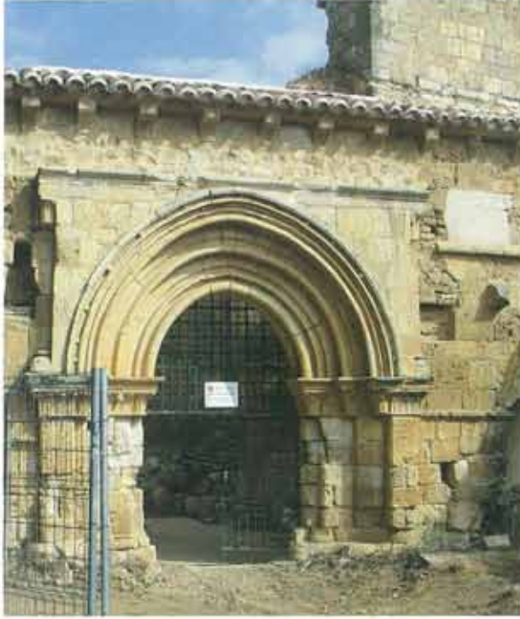
Vista de la portada sur en el momento de comenzar la intervención, en el lateral derecho aparece la inscripción fundacional, la cual está tapada por la capa de engasado y yeso que entre 1.994 y 1999 realizaron los especialistas del Centro de Estudios del Románico por encargo de la Junta de Castilla y León. Situado en la parte inferior izquierda de la lápida anteriormente mencionada se puede ver el hueco dejado por el arranque de la inscripción desaparecida entre Agosto de 1.970 y Agosto de 1.971.
