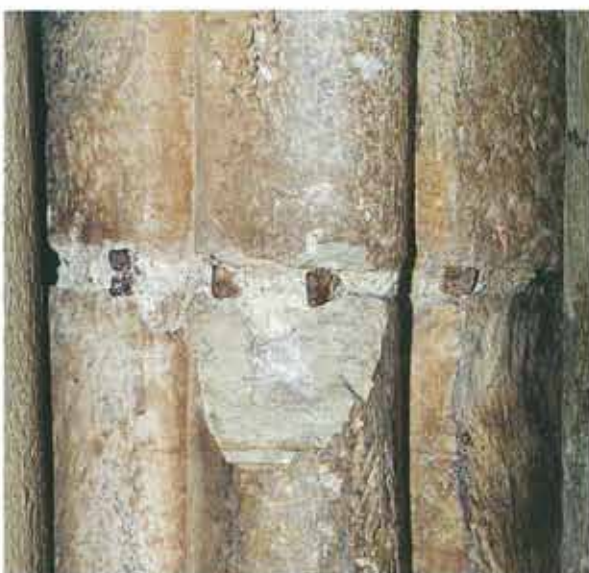
Desprendimientos provocados por el aumento de volumen del óxido de las cuñas metálicas, colocadas en las juntas
