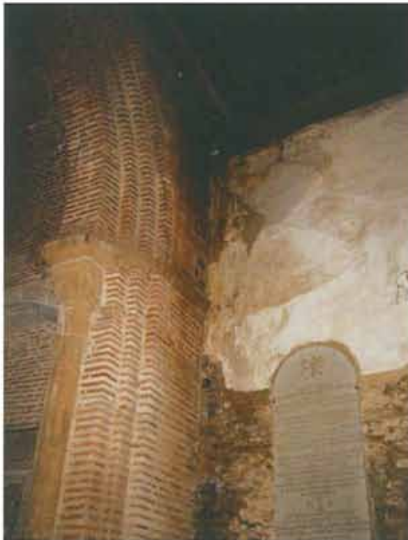
Detalle del interior de la nave en el encuentro del muro sur con el muro del presbiterio, en la que se aprecia la presencia de humedades
