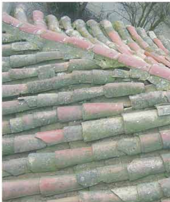
Detalle de la cubierta en la que se aprecia la pérdida y el desplazamiento de la teja cerámica
