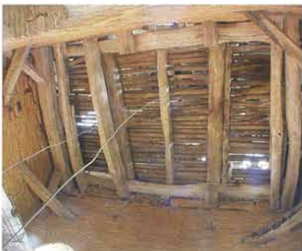
Detalle del forjado en techo del cuerpo inferior de campanas y piso del cuerpo alto, con barrote forjado deteriorados
