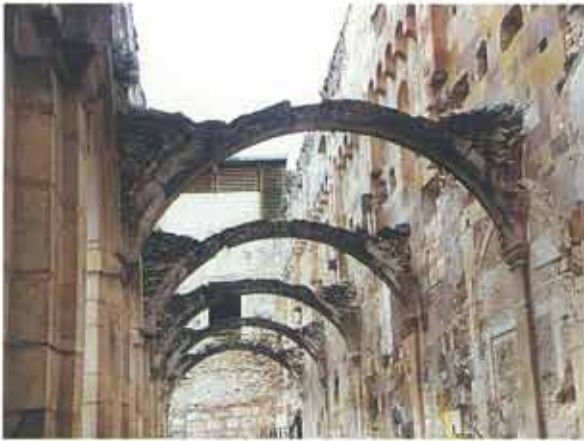
Estado previo del claustro procesional. Los restos existentes de los arcos presentaban un grave deterioro y peligro de derrumbe
