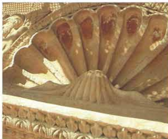
Detalle de policromía existente en la Venera de fachada principal. Efecto pictórico de profundidad
