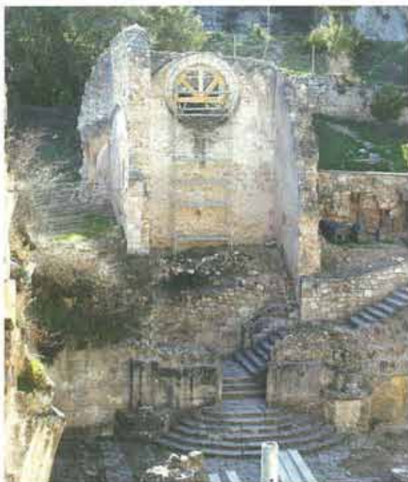
Aspecto general de una de las partes del Monasterio durante el proceso de intervención, en el que se ha pretendido tomar medidas urgentes para garantizar la estabilidad de los elementos constructivos, y ofrecer un recorrido seguro a los visitantes.
