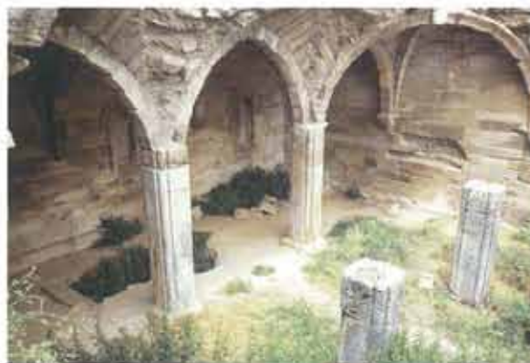
Estado de la sala capitular antes de su consolidación. Obsérvese la pérdida de los tramos de bóvedas
