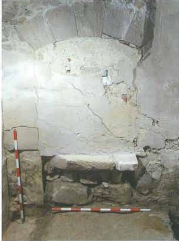
Arco abierto en el muro norte y antiguo piso terrero de la nave
