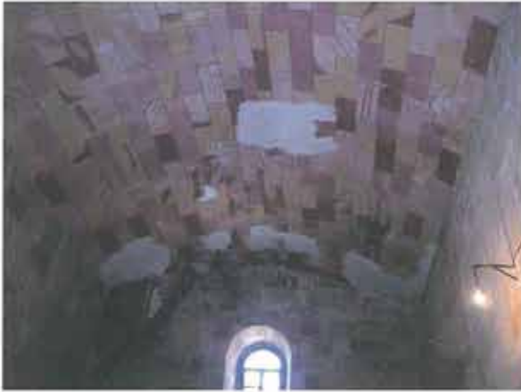
Detalle del falso techo de escayola y cañizo, existente en la nave, en forma de bóveda rebajada, que simulaba un despiece de sillares de piedra en tonos rosáceos.
