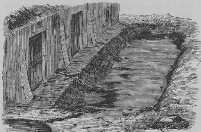
Fig. 2.—Vista de la zanja para estiércol, supuesta vacía y antes de la reforma adoptada por M. Vandercolme.
