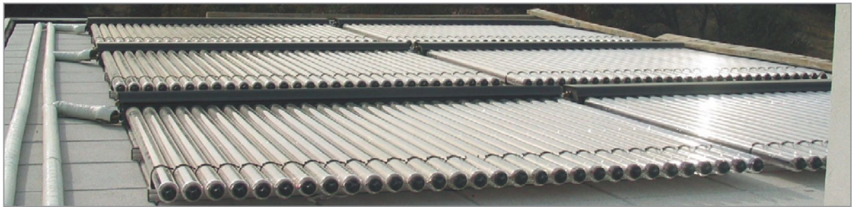
Superposición de captadores en cubierta plana
