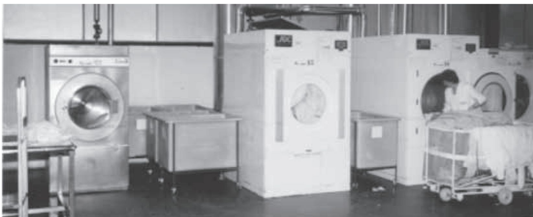
Figura 7. Ejemplo de lavandería industrial.
