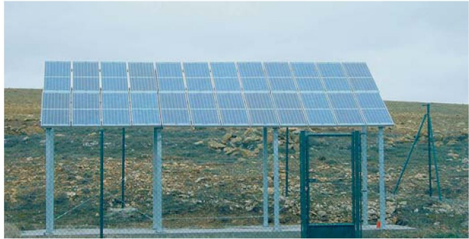
Instalación fotovoltaica aislada para riego
