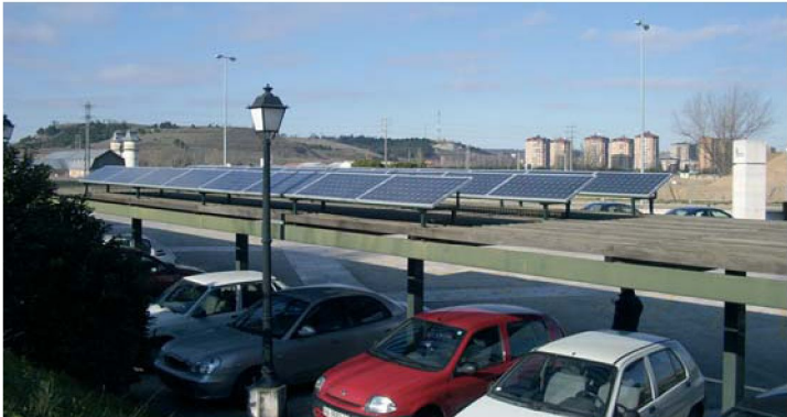
Módulos solares fotovoltaicos
