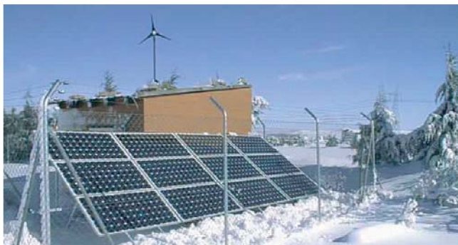
Instalación eólico-fotovoltaica aislada
