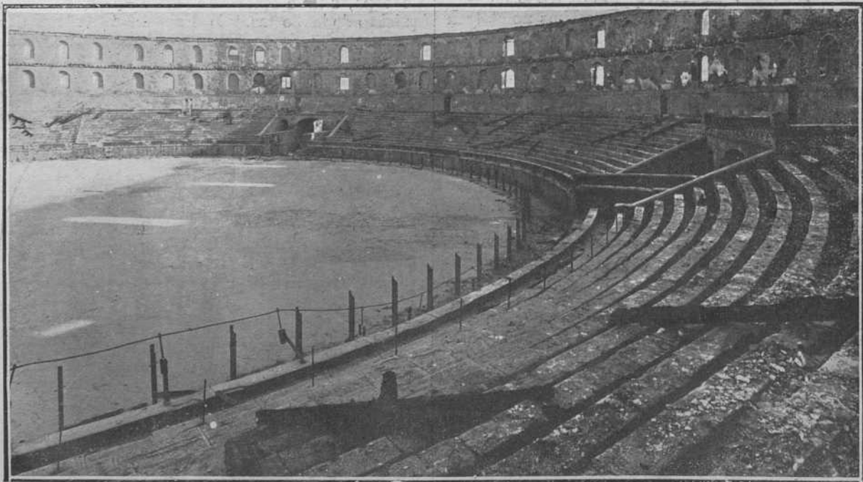
La Plaza de toros de Logroño destruida á consecuencia de un terrible incendio
