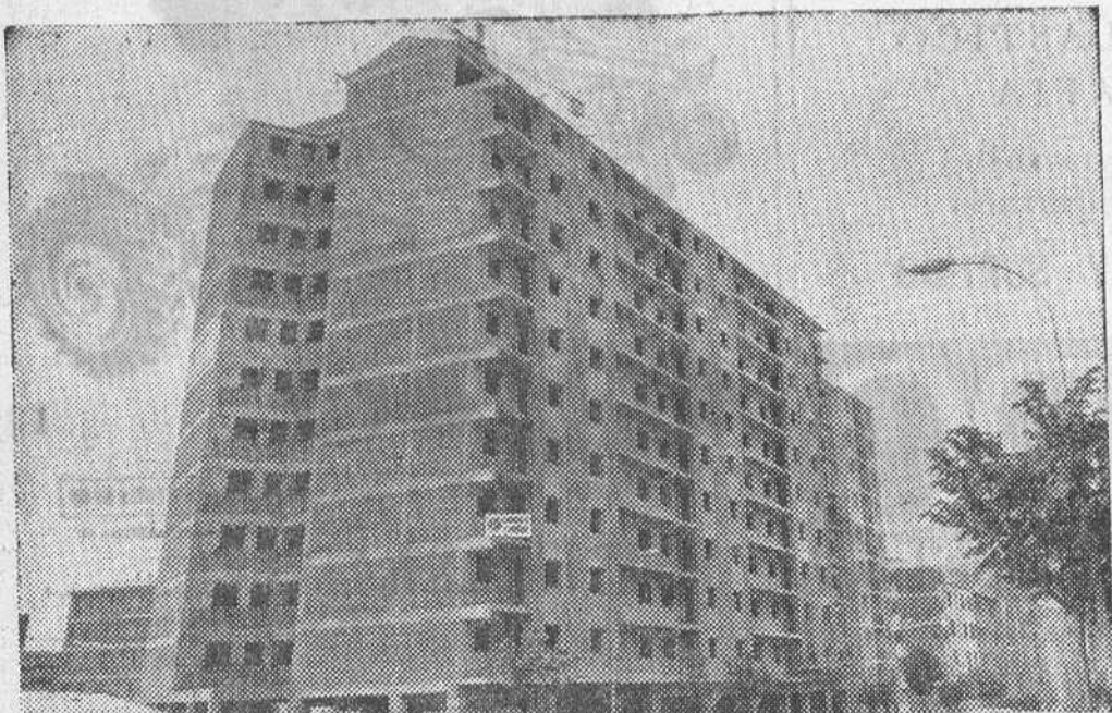
GRUPO "EL CID", INSTALADO POR COINSA
