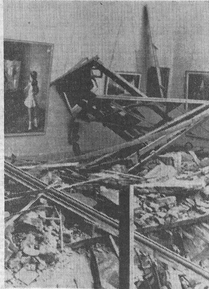
Sevilla. — El hundimiento del Pabellón Mudéjar de la plaza de América ocurrido en Sevilla, ha sido motivado por el mal estado de conservación en que se encontraba el inmueble y a las fuertes lluvias caídas estos días. En la telefoto, un aspecto parcial del referido hundimiento. — (Foto CIFRA)
