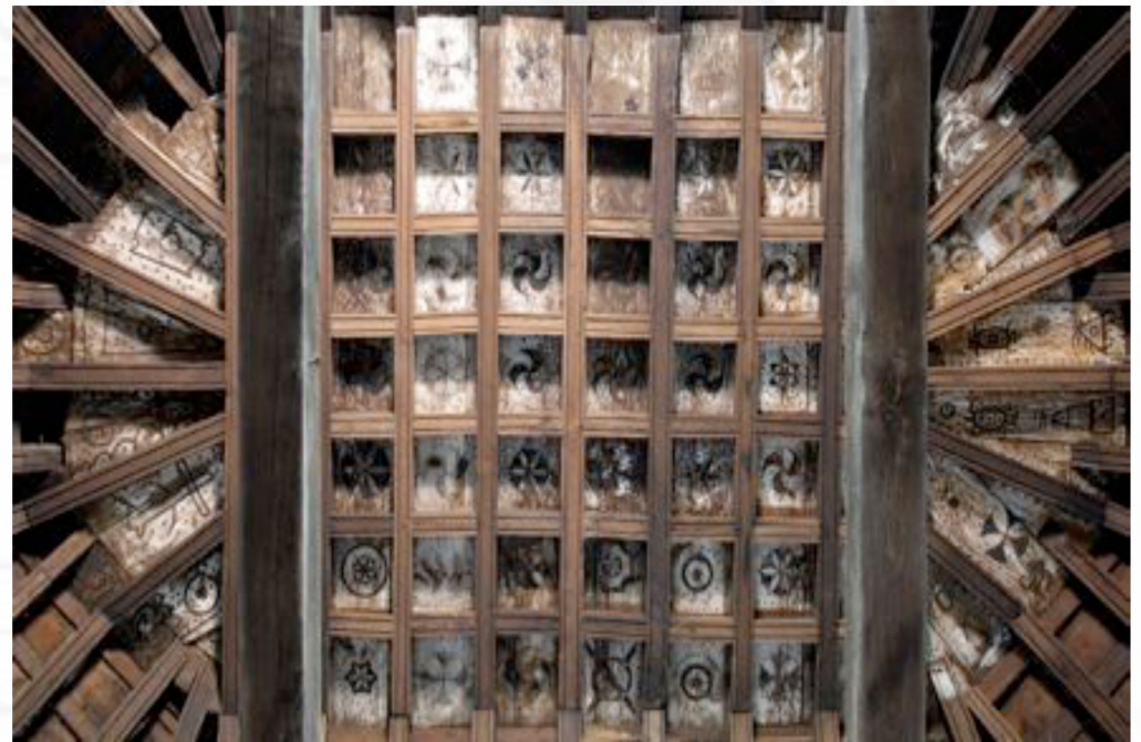
almizate de la cubierta
