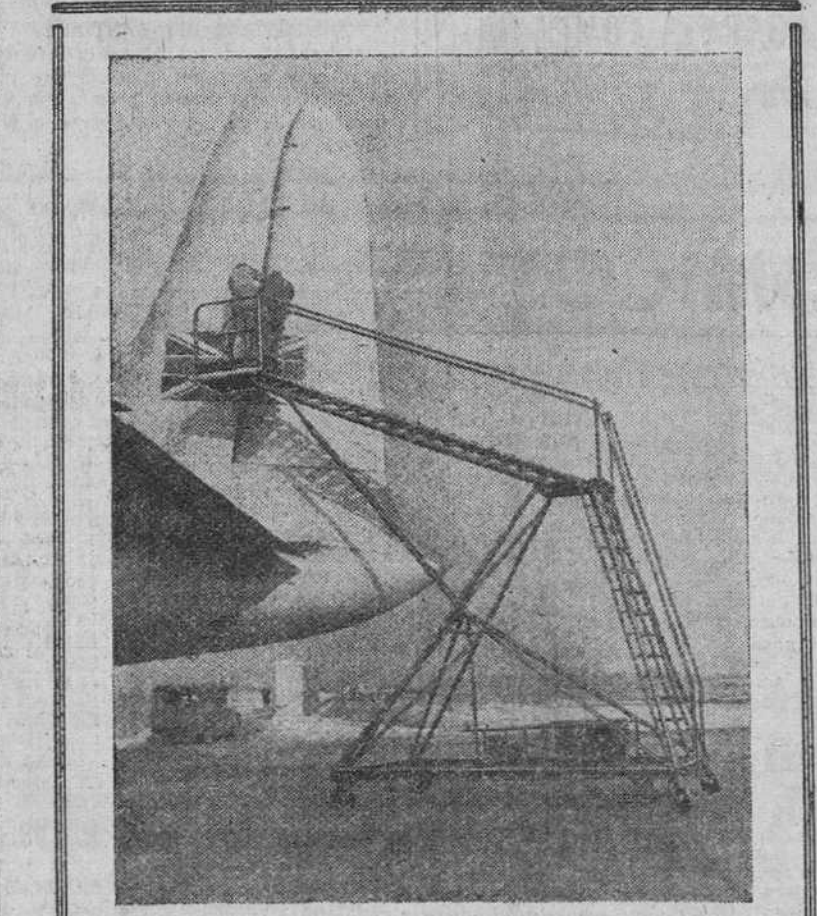
PLATAFORMA GIGANTE Esta plataforma está titulada con el nombre de "Jirafa" a la que se ha ideado especialmente para facilitar las reparaciones en los grandes aviones de transporte. Tiene una altura de siete metros y admite cuatro obreros. (Foto Calpe)
