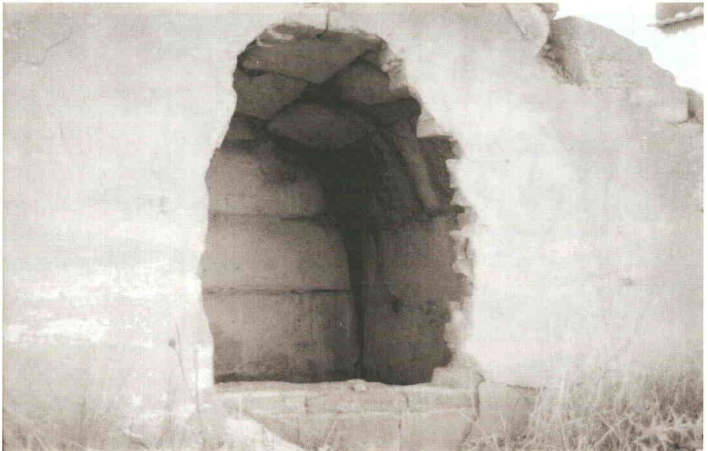
Moreruela de Infanzones. Fuente de los Caños, con su estructura pétreo desfigurada por el revestimiento de cemento.
