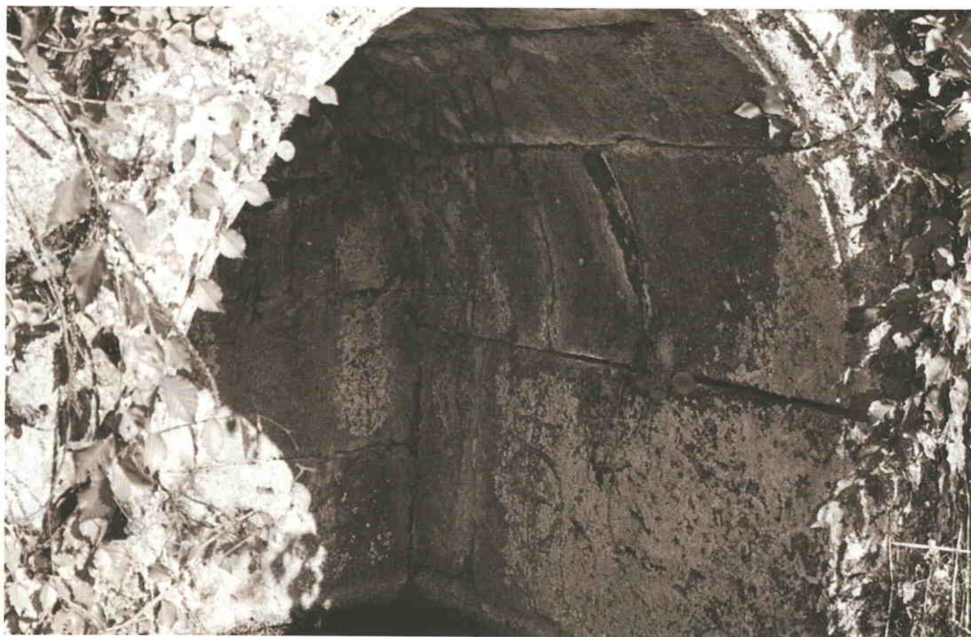
Gramedo. Fuente del Monasterio (Arriba: vista general; abajo: "cáliz" grabado en el interior de la bóveda).
