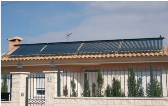
Instalación solar térmica para uso doméstico (ACS y calefacción).
