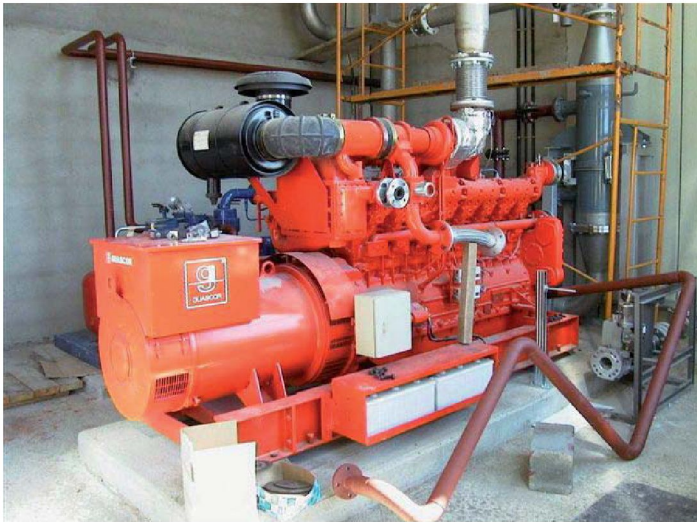
Motogenerador EDAR de Zamora.
