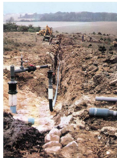
Recogida del gas en vertedero.
