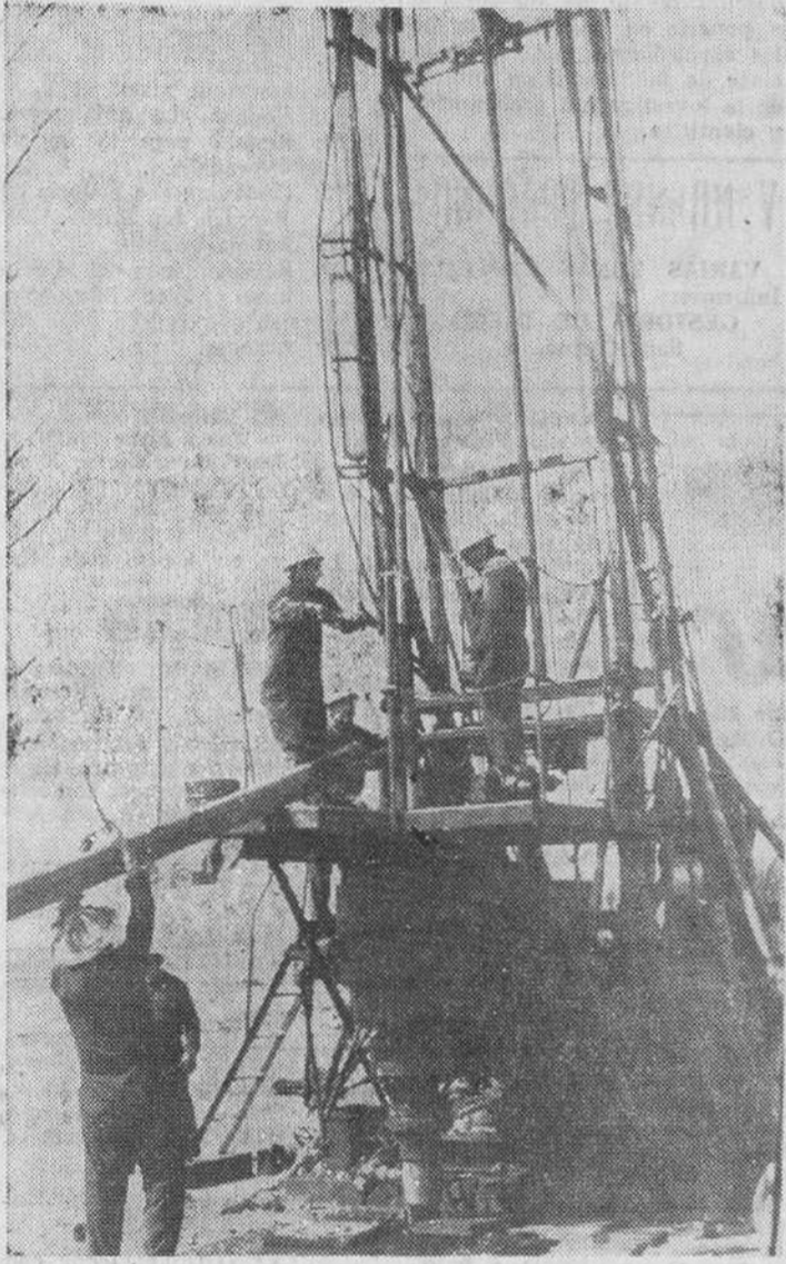
Operarios de Campsa introducen los tubos de producción con la máquina «Cardwell» en el pozo que vienen acondicionando en el campo de la Lora.
