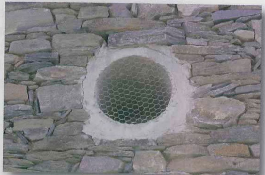
La malla metálica tipo "gallinero" o "conejera" está contraindicada para cerrar accesos, ya que puede convertirse en una trampa mortal para los murciélagos.
