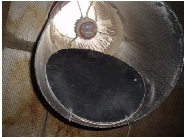
Figura 9. Chimenea de ventilación
