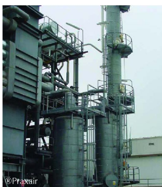
Planta industrial de reformado de gas natural
