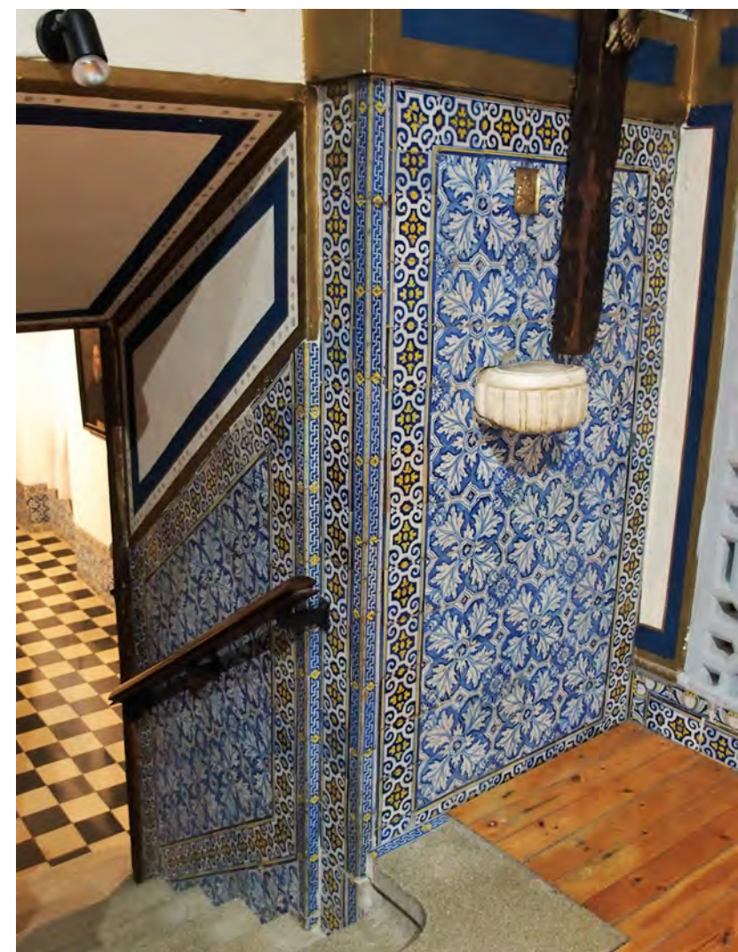
Detalle de los arrimaderos de la escalera y paredes del coro alto
