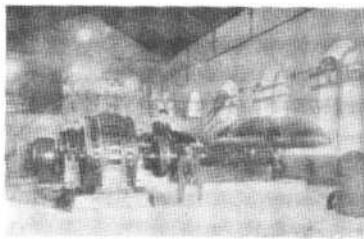
Hidroeléctrica de Pesquera. Interior de la sala de máquinas.
