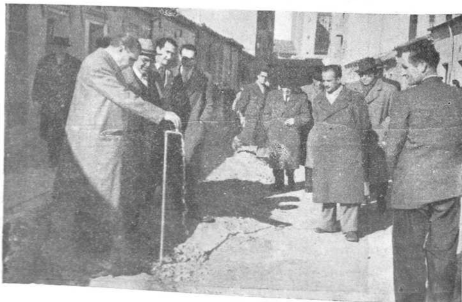
... la presión del agua en las tuberías instaladas en las calles.
