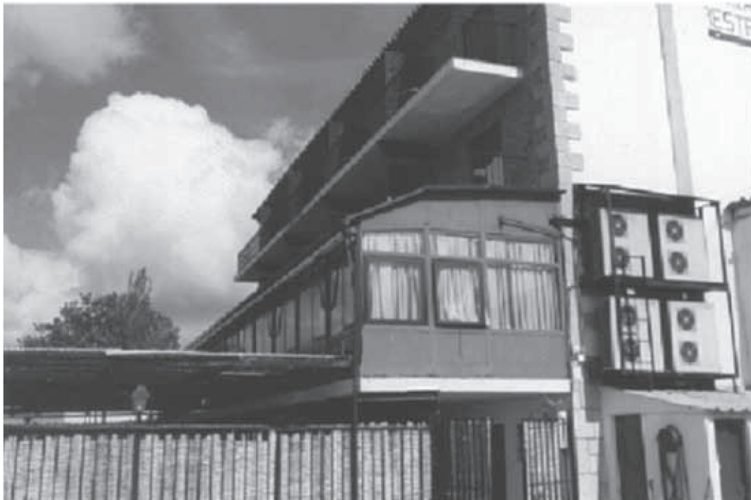
Figura 21. Instalación de aire acondicionado para zonas comunes.
