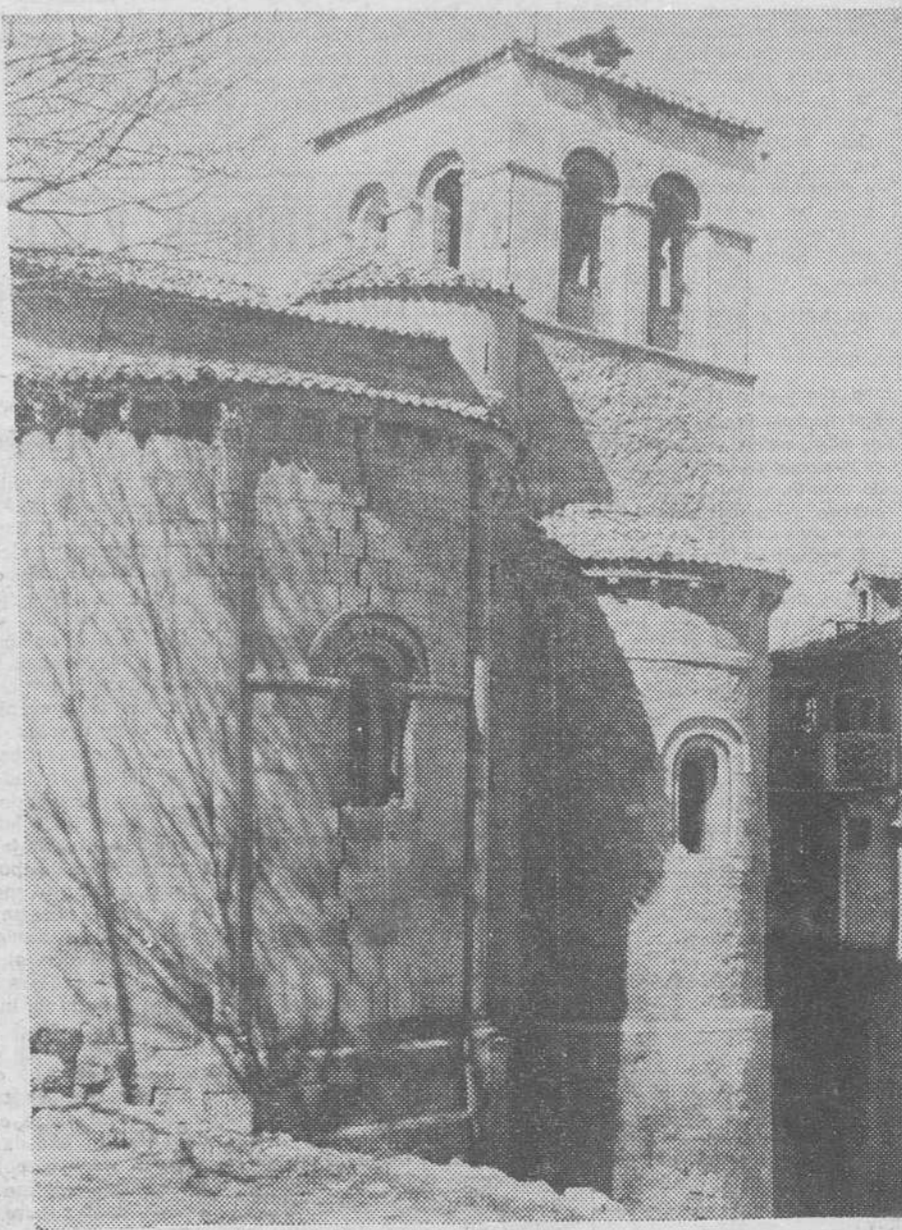
Una peligrosa grieta atraviesa de arriba abajo el ábside de la Iglesia de San Nicolás, una destacada muestra del románico segoviano. — (Foto EFE-FIEL)
