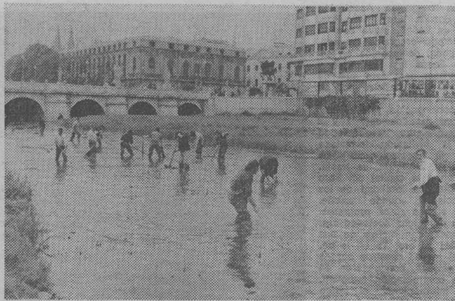
Estos días se llevan a cabo trabajos de limpieza en el cauce del río Arlanzón, a su paso por el centro de la ciudad, a cargo de la contrata municipal de limpieza. La fotografía de «Fede» muestra un momento de esos trabajos.
