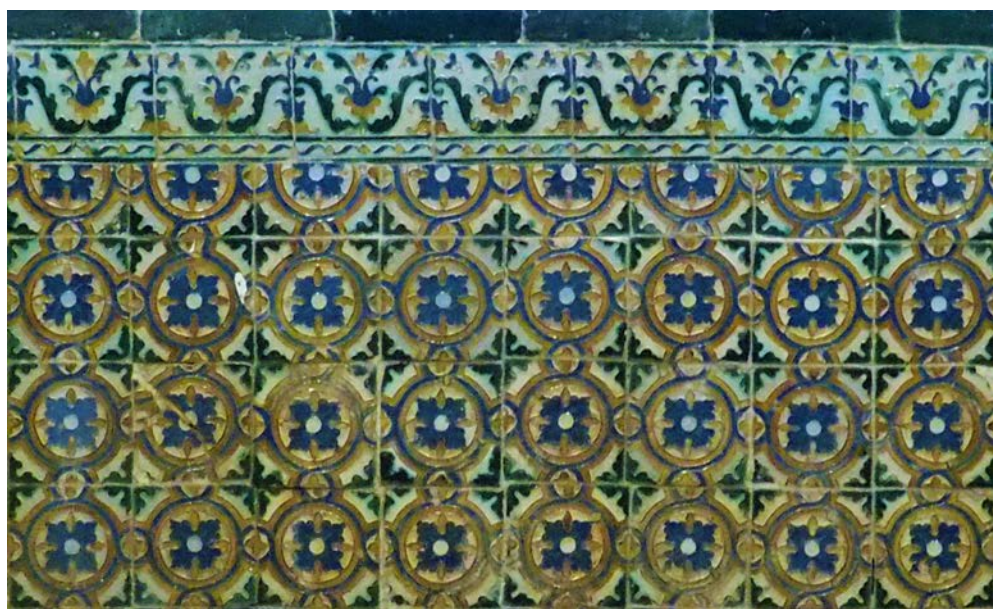
Detalle del arrimadero de la bajoventana central del refectorio del convento de Sancti Spiritus el Real de Toro
