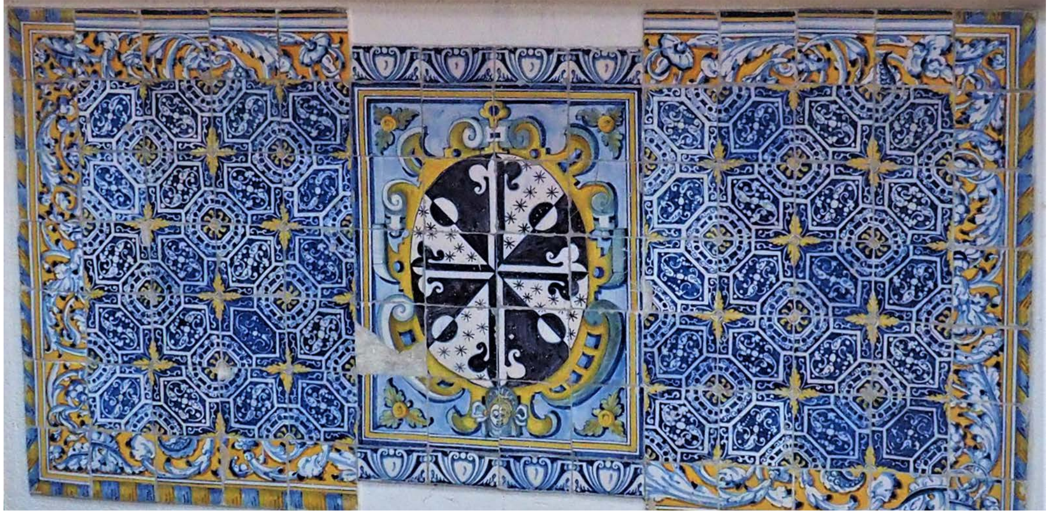
Vista del frontal de azulejos recolocado en la chimenea de una estancia junto a la biblioteca del monasterio de San Esteban
