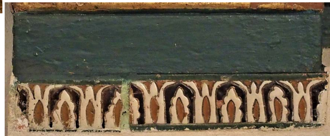
Vista y detalle de los alízares de “cuerda seca” colocados en el banco de obra sobre el que descansa el retablo mayor
