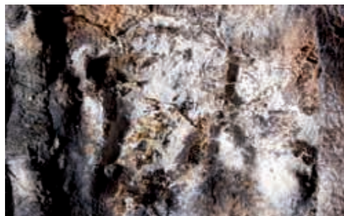
Detalle, estado que presenta la actividad microbiológica sobre el soporte proteínico
