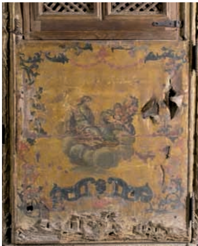
Estado inicial de la parte inferior de la puerta
