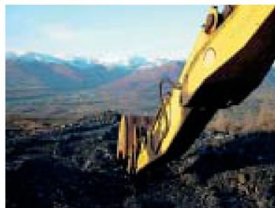
Vertido de escombros en el Alto Bierzo.
